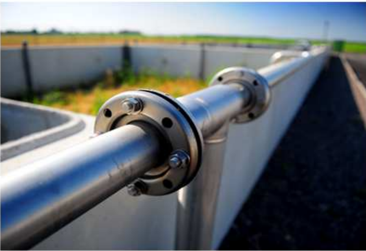
STATION D'EPURATION DE DRUYE Route de Villandry (après le hameau de la Nauraie)
